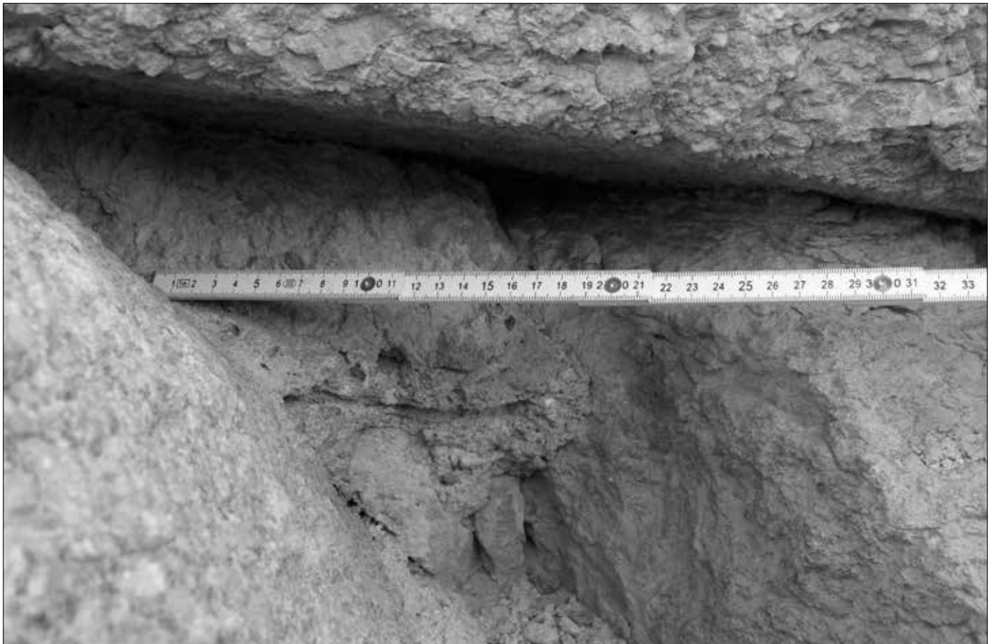
An der Mykerinos-Pyramide wurde richtig geschludert. Zwischenräume bis über zwanzig Zentimeter sind die Regel. Sie wurden notdürftig mit Mörtel verfüllt. (Hier: Westseite)
